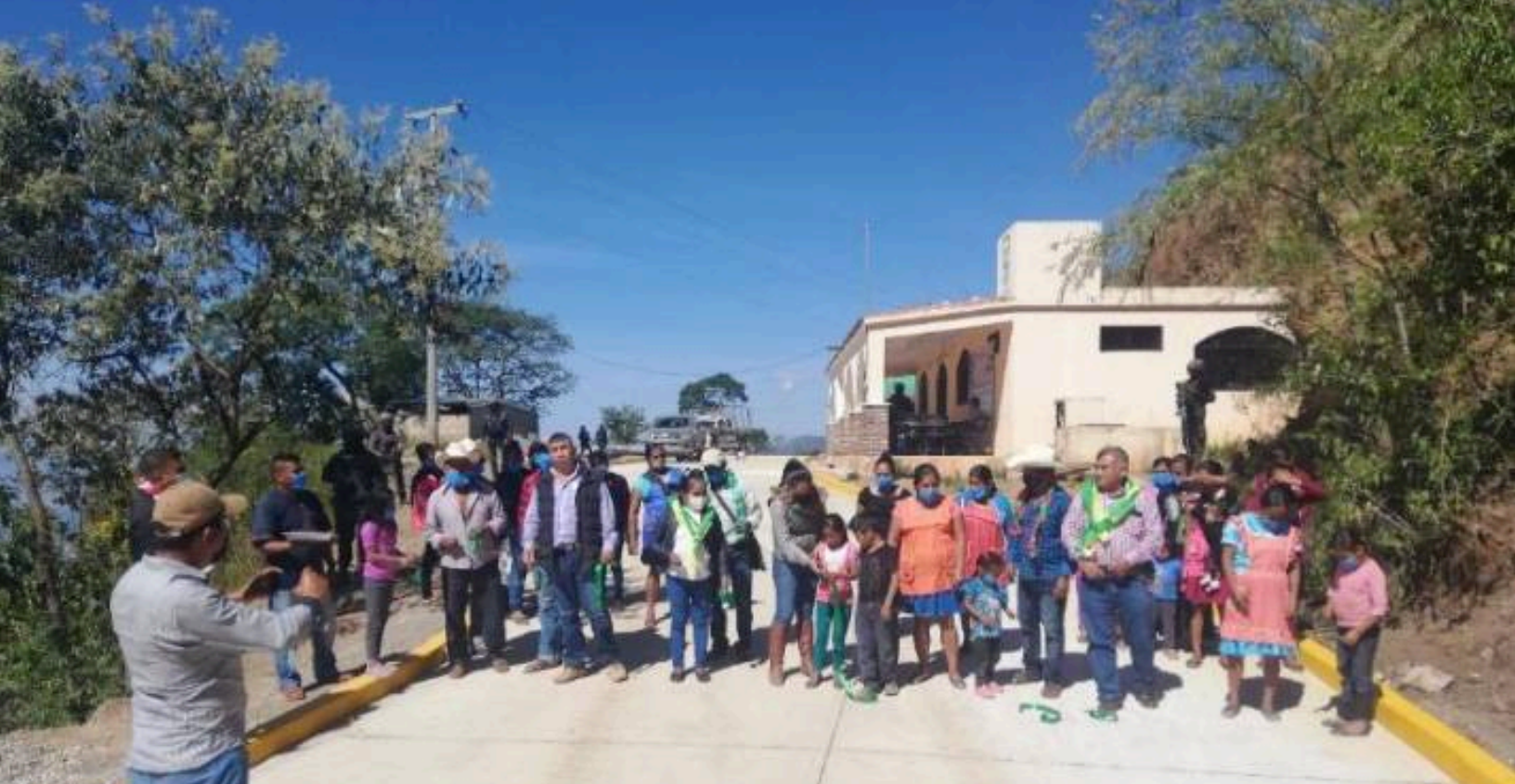
Construcción de pavimentación con concreto hidráulico en la calle principal, localidad Tlalojcan.
