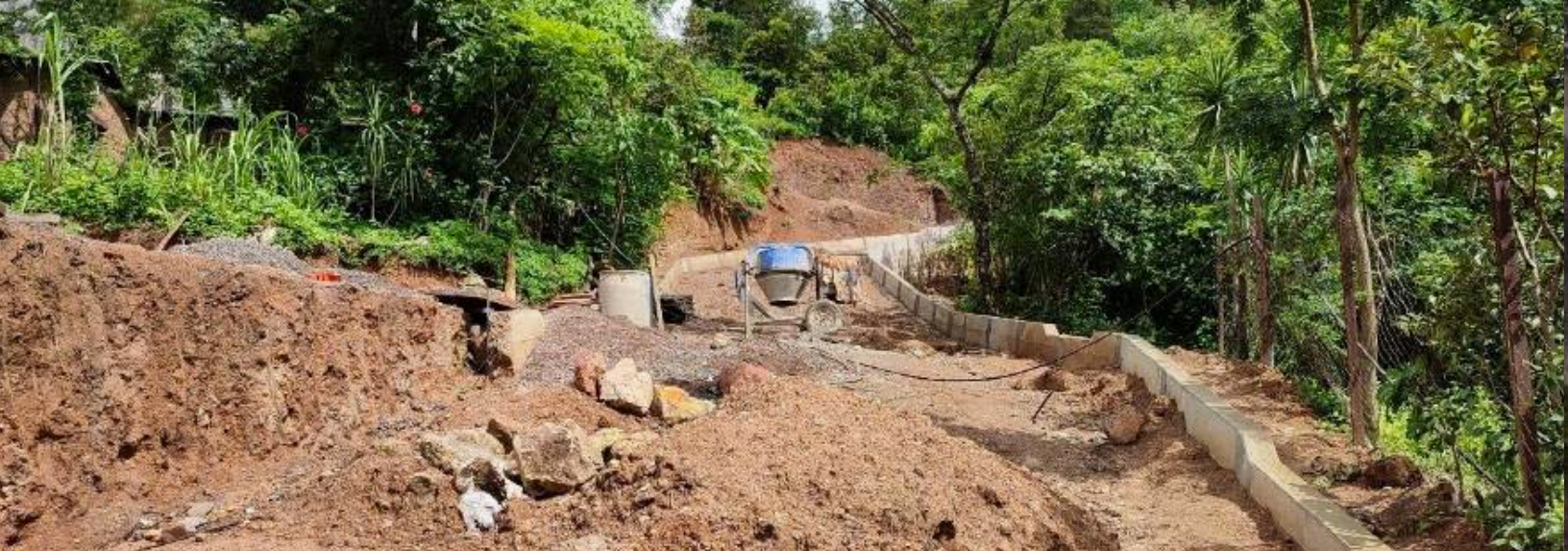
Construcción de pavimentación con concreto hidráulico de la calle principal en localidad Tlaixcoatpan.
