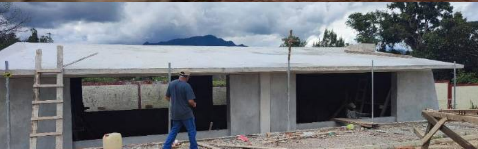
Construcción de edificio "j" (aulas de medios) en est. Reg. 751 t/c + obra exterior (plaza y/o andadores + red eléctrica + murete de acometida eléctrica).
